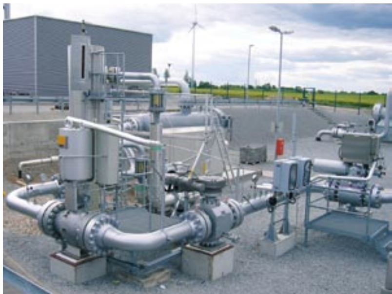
Gasdruckregelanlage auf dem Speicher der KST GmbH
