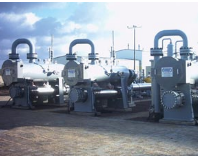
Regelschienen 1 – 3 auf dem UGS Bad Lauchstädt der VNG AG
