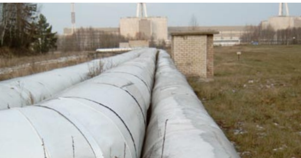
Fernwärmeleitungen ins Kraftwerk
