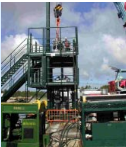
Das Rack wird für einen Probelauf auf dem Werksgelände vormontiert. Zum Zu- bzw. Abführen der Einzellrohre dient die Pickup- Laydown-Maschine (Hintergrund).
