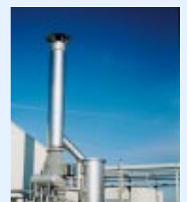
Titelbild Anlage zur Brüdengasverbrennung mit Abwärmenutzung
