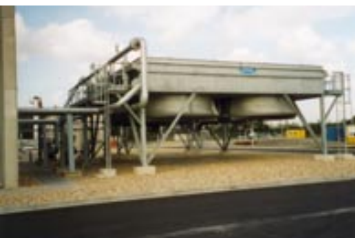
Erdgasspeicher Kalle - Verdichter 5
