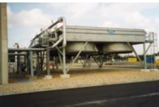
Erdgasspeicher Kalle - Verdichter 5
