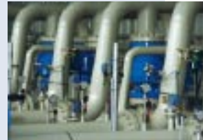
Verteilerhalle einer Kaverneanlage
