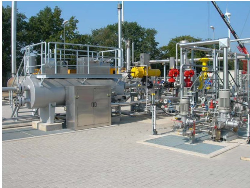
Freiwasserabscheider der Eingangsleitung / Pumpengruppe
