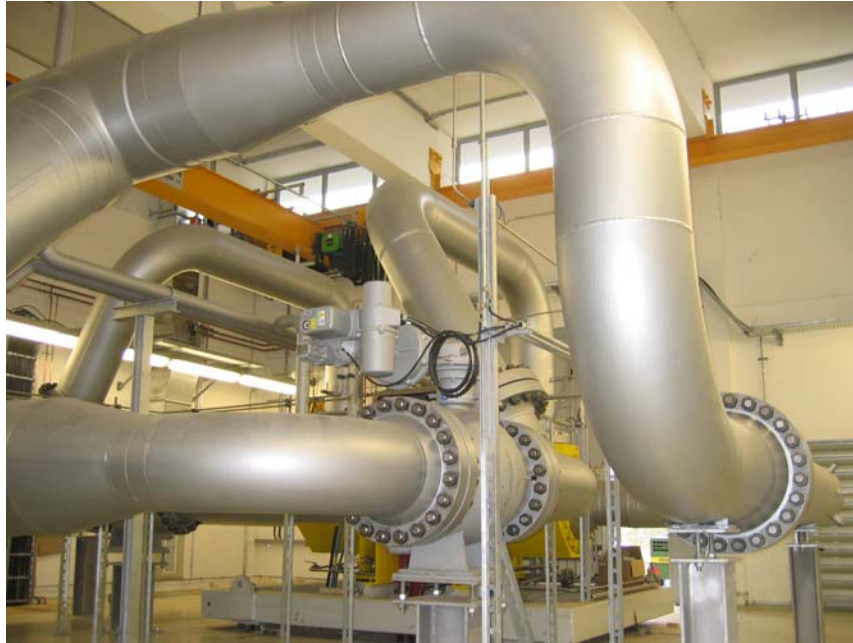
Rohrpiping in der Verdichterhalle, Rohrenweite 18“, 20“ und 28“
