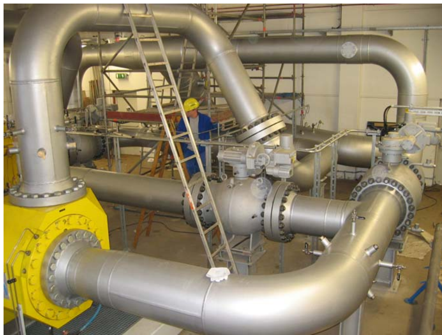
Rohrpiping in der Verdichterhalle, Rohrenweite 18“, 20“ und 28“
